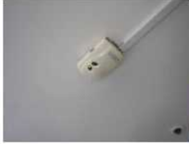
가스누설경보기의 탐지부가 설치된 사례
