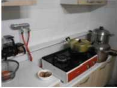
가스누설경보기가 미설치된 경우
