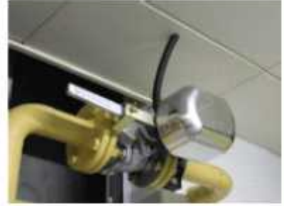
가스누설경보기의 차단밸브가 설치된 사례
